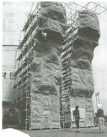
北信越国体にも使用する B & G体育館脇の特設ウォール
